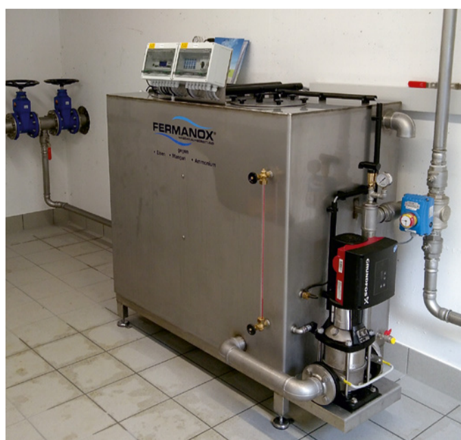
Bild 4: Anlage zur unterirdischen Wasseraufbereitung beim Wasserverband Kleinhöhenrain
