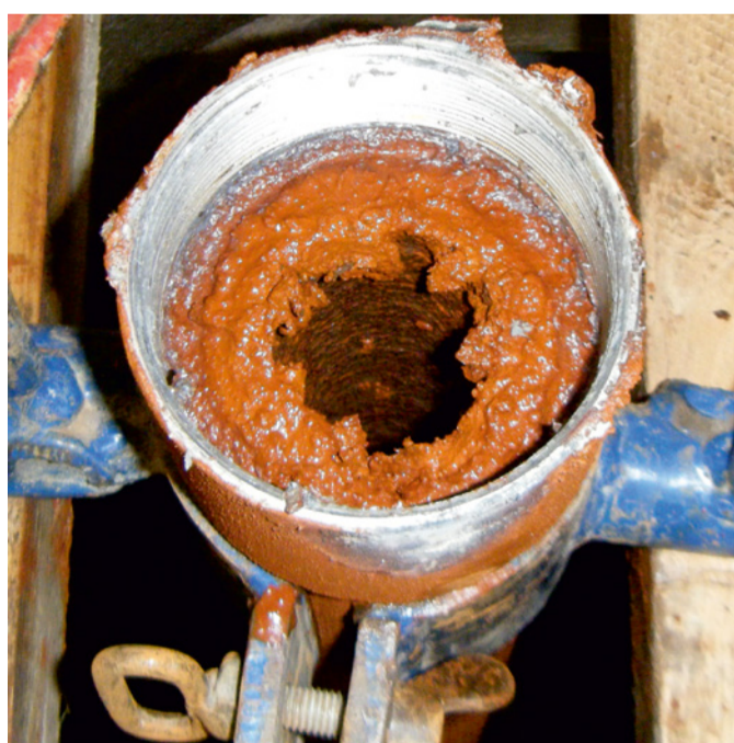
Bild 1: Verockerungen (im Bild in der Steigleitung einer Unterwasserpumpe) können bei der Verwendung von eisenhaltigem Grundwasser im gesamten Wasserversorgungssystem auftreten
