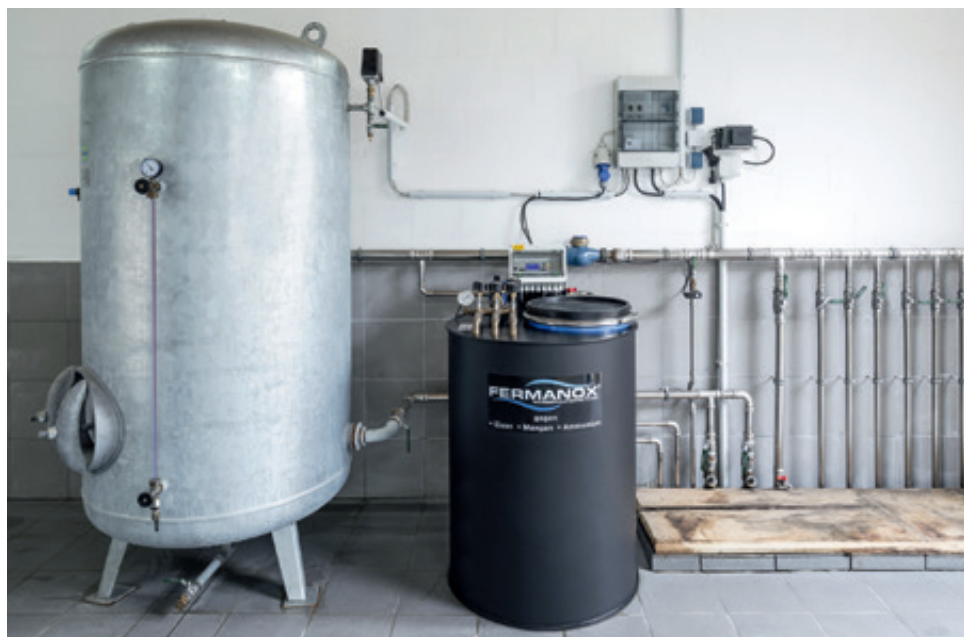
Abb. 4 – Wasserversorgung eines landwirtschaftlichen Betriebs mit unterirdischer Wasseraufbereitung für einen Wasserbedarf von ca. 50 m³/Tag
