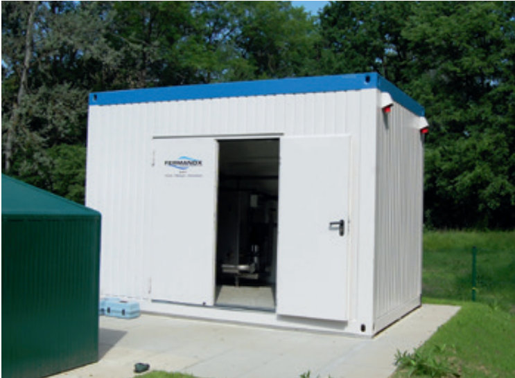
Abb. 6 – Wasserwerk mit UEE im Container neben einer Brunnenstube
